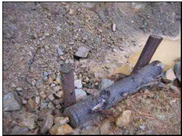
Alcantarillas tapadas con material de arrastre
