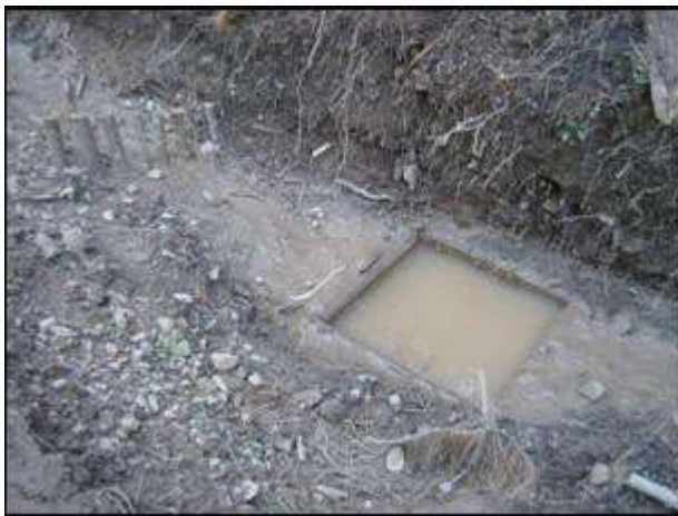
Foso saturado con sedimentos
