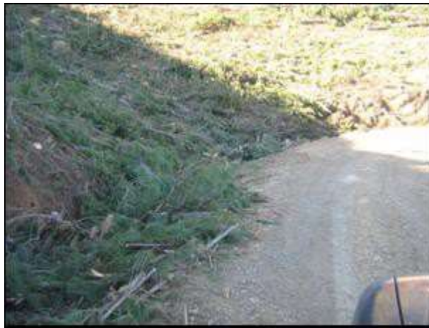
Cuneta en camino contaminada con desechos de operación
