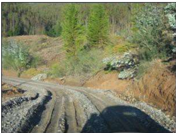
Carpeta de rodado con ahuellamiento y desplazamiento del material
