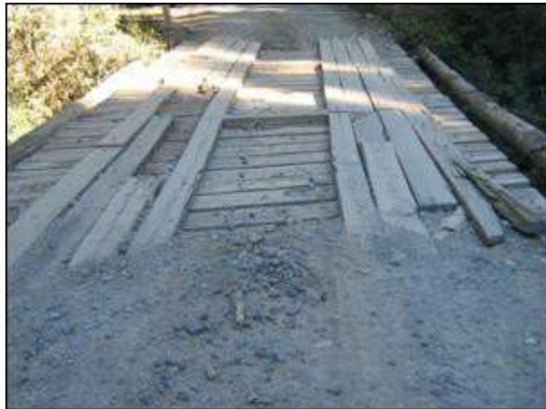
Puente con Rodado dañado
